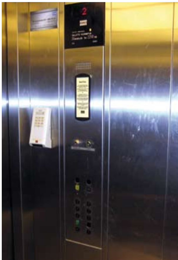
Kuva 14. Kulkukortinlukija on asennettu liian korkealle. (Kuva: JS)
